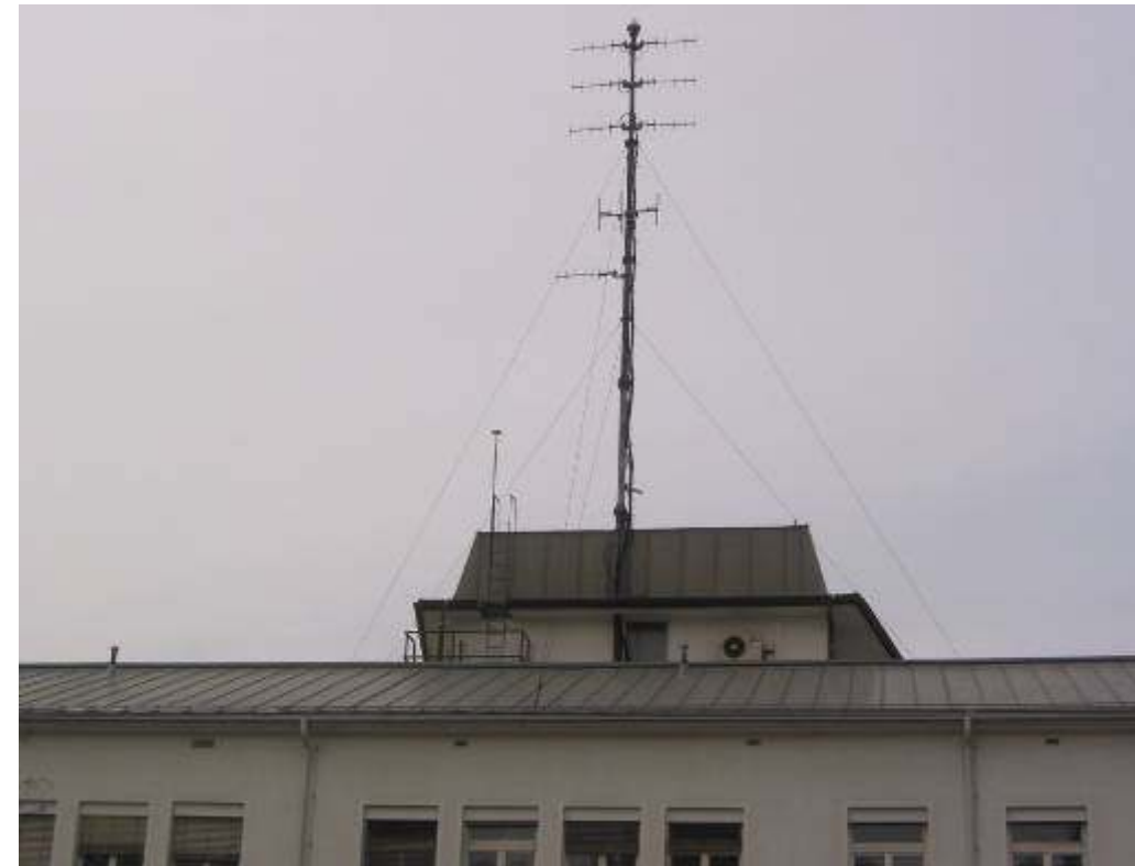
Referenzstation am Aufnahmegebäude Bf. Graz
