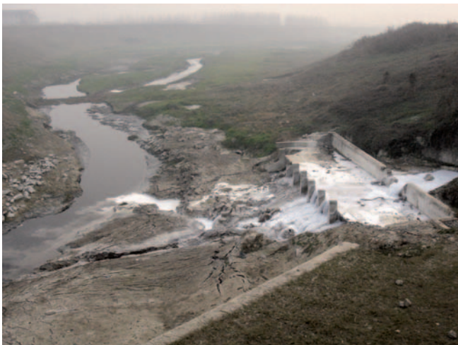
Unkontrollierte Einleitung des nicht geklärten Abwassers aus einer Papierfabrik
