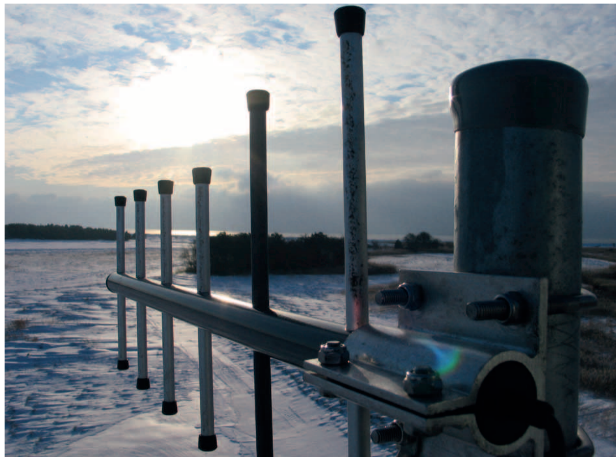
Referenzstation am Fehmarnbelt: Im Bild eine Funkantenne für den Versand der GPS-Korrekturdaten auf der Mega-Baustelle.
